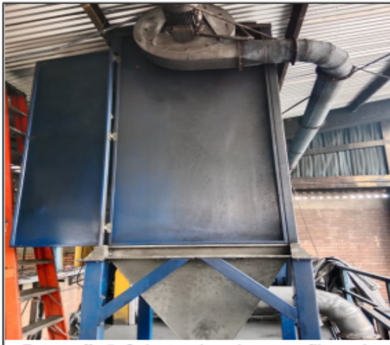
Fotografía 5. Colector de polvos con filtros de mangas
