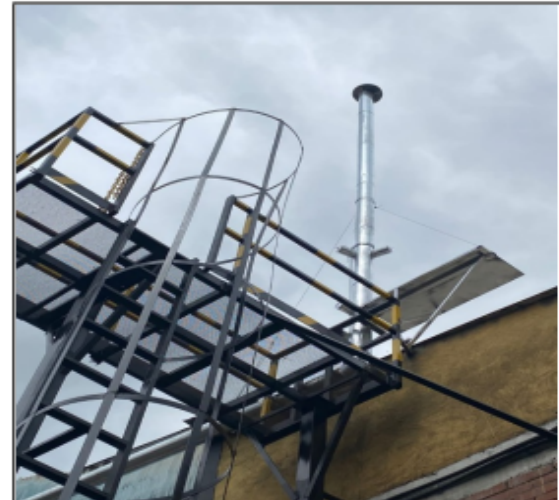
Fotografía 6. Ducto, niples y plataforma de muestreo de la máquina Untha
